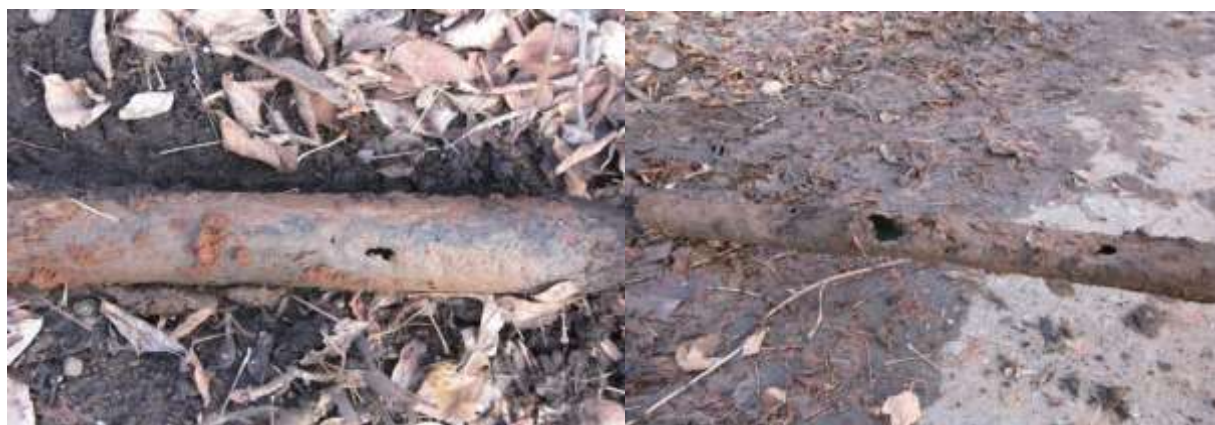
Рисунок – Очаги разрушений
