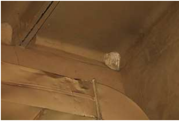
Фото 27 - Визуальный осмотр трещин стен здания 25 (хлораторная)
