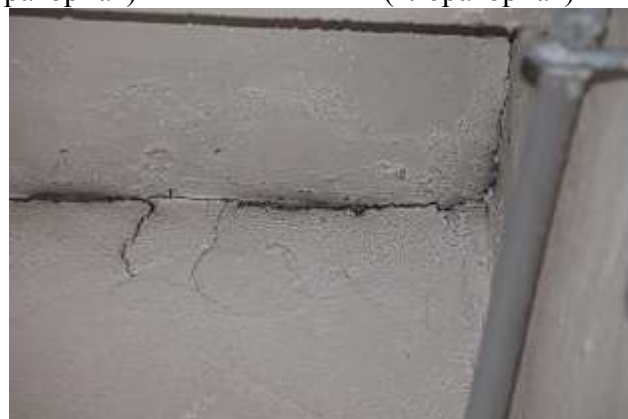
Фото 24 - Визуальный осмотр трещин стен здания 25 (хлораторная)
