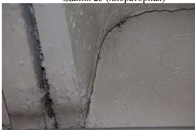
Фото 25 - Визуальный осмотр трещин стен здания 25 (хлораторная)
