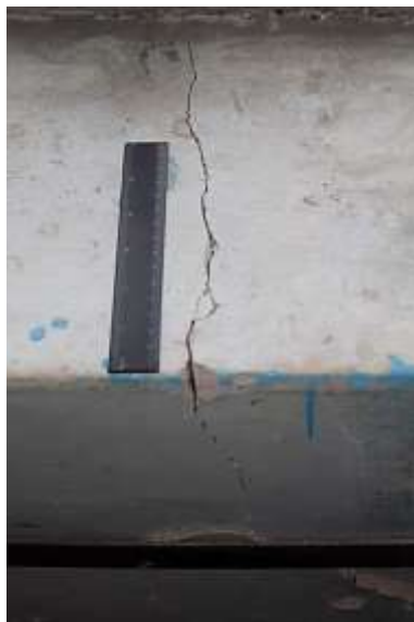
Фото 21 – Визуальный осмотр трещин стен здания 25 (хлораторная)
