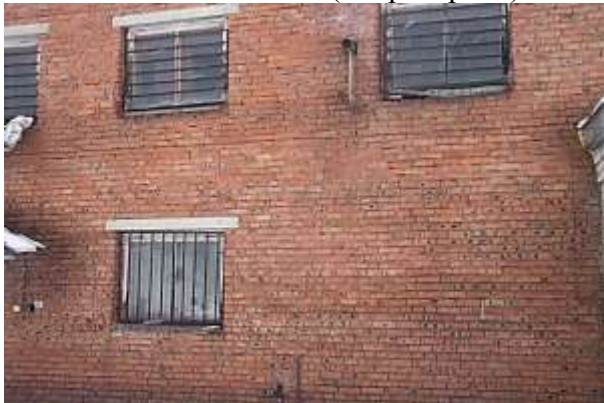
Фото 31 - Визуальный осмотр трещин стен здания 25 (хлораторная)
