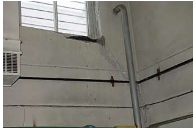
Фото 28 - Визуальный осмотр трещин стен здания 25 (хлораторная)
