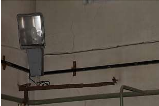
Фото 29 - Визуальный осмотр трещин стен здания 25 (хлораторная)
