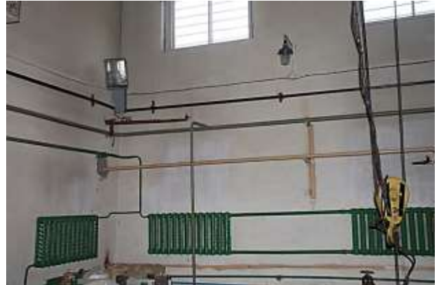
Фото 30 - Визуальный осмотр трещин стен здания 25 (хлораторная)
