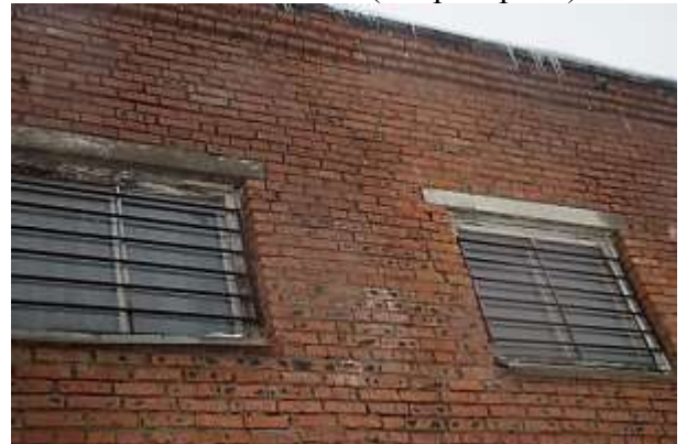
Фото 32 - Визуальный осмотр трещин стен здания 25 (хлораторная)
