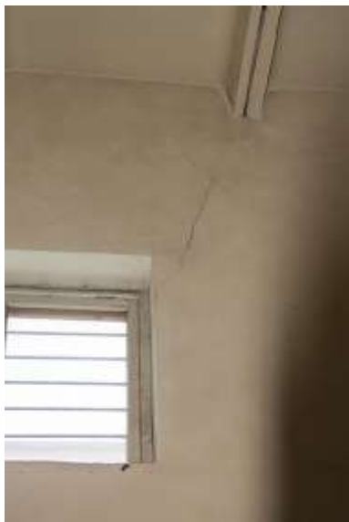
Фото 20 – Визуальный осмотр трещин стен здания 25 (хлораторная)
