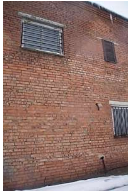
Фото 34 - Визуальный осмотр трещин стен здания 25 (хлораторная)
