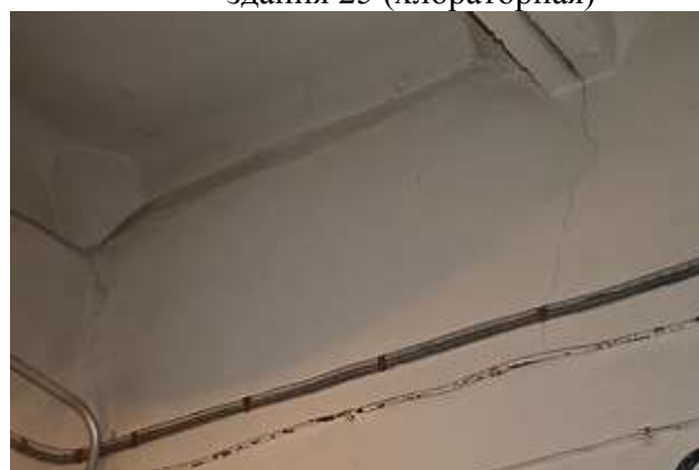
Фото 26 - Визуальный осмотр трещин стен здания 25 (хлораторная)
