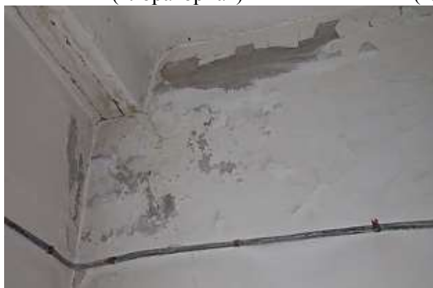
Фото 23 - Визуальный осмотр трещин стен здания 25 (хлораторная)
