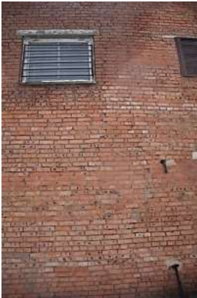
Фото 33 - Визуальный осмотр трещин стен здания 25 (хлораторная)
