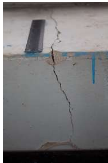
Фото 22 – Визуальный осмотр трещин стен здания 25 (хлораторная)
